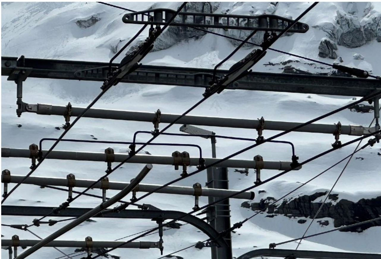
Linea trifase. La terza fase è collegata al binario. Attraversando uno scambio una fase viene disinserita facendo abbassare un pantografo.
