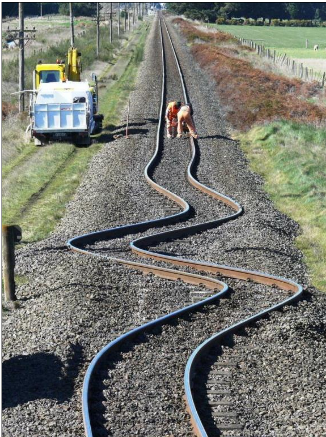
Non stanno posando binari. È solo il dopo-terremoto in Nuova Zelanda (Canterbury).
